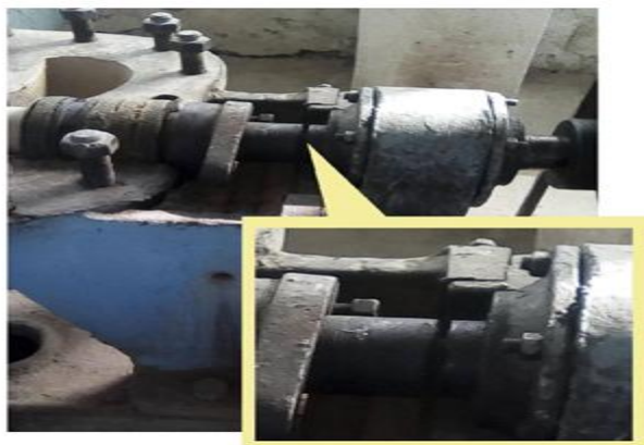
Рисунок 4. Узунский район. Повреждение вала и лопастей насосного агрегата насосной станции Астана-1.
